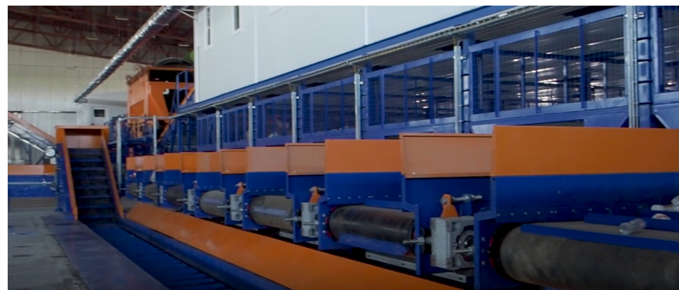
Комплекс автоматической сортировки ТКО
